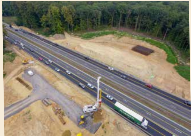
Vue aérienne des travaux de fondation, terres locales entreposées et bandes de circulation temporaires (©Life+OZON)
